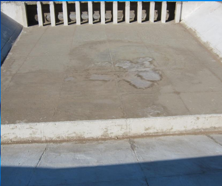
Figura 5.- Cárcamo de bombeo, seco, limpio y desinfectado previo a la temporada.
