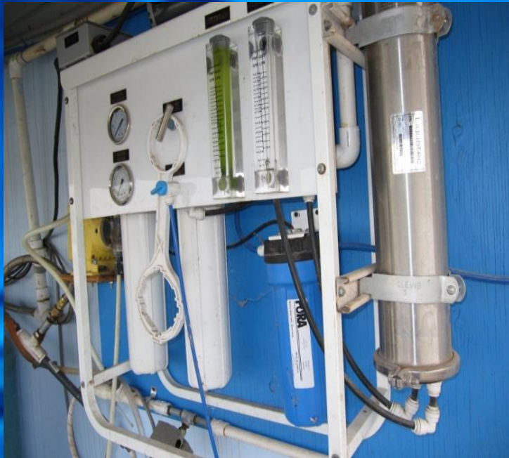
Figura 17.- Sistema de filtrado y purificación de agua utilizado en la planta de proceso. Es aquí donde se realiza la purificación del agua que será utilizada durante el procesamiento del producto.
