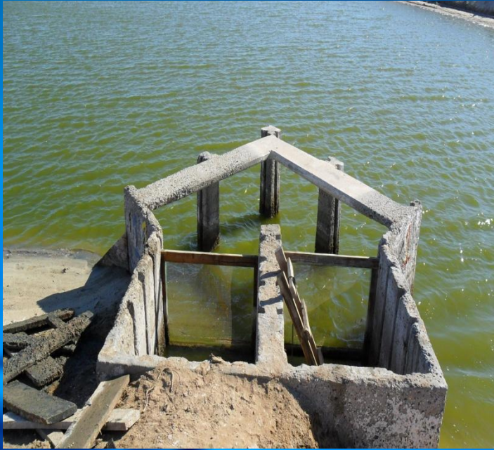
Figura 10.- Compuertas de salida limpias, previo a la cosecha del estanque.
