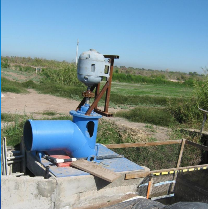
Figura 8.- Estación de bombeo limpia, libre de basura y con filtros para evitar la entrada de sólidos y organismos al reservorio.
