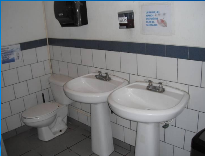
Figura 7. Lavado de manos con jabón, papel secante, bote de basura y señalamiento, en el área de baños, son requerimientos mínimos para cumplir con las Buenas Prácticas, en plantas de procesamiento primario.
