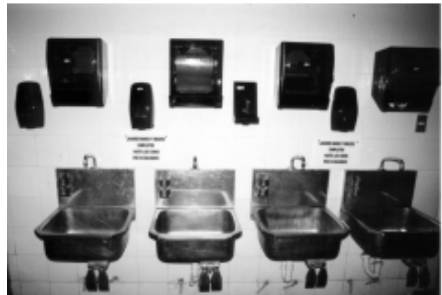
Figura 4.5 Estación de lavado de manos deberá ser tal que pueda cubrir las necesidades del flujo del personal y estar provistas de jabón y desinfectante para manos.
