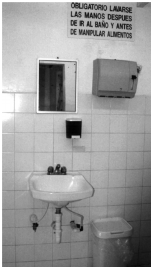
Figura 4.4 Instalaciones para el lavado de manos con jabón, papel secante, bote de basura y señalamiento, en el área de baños, son requerimientos mínimos para cumplir con las buenas prácticas de manufactura.
