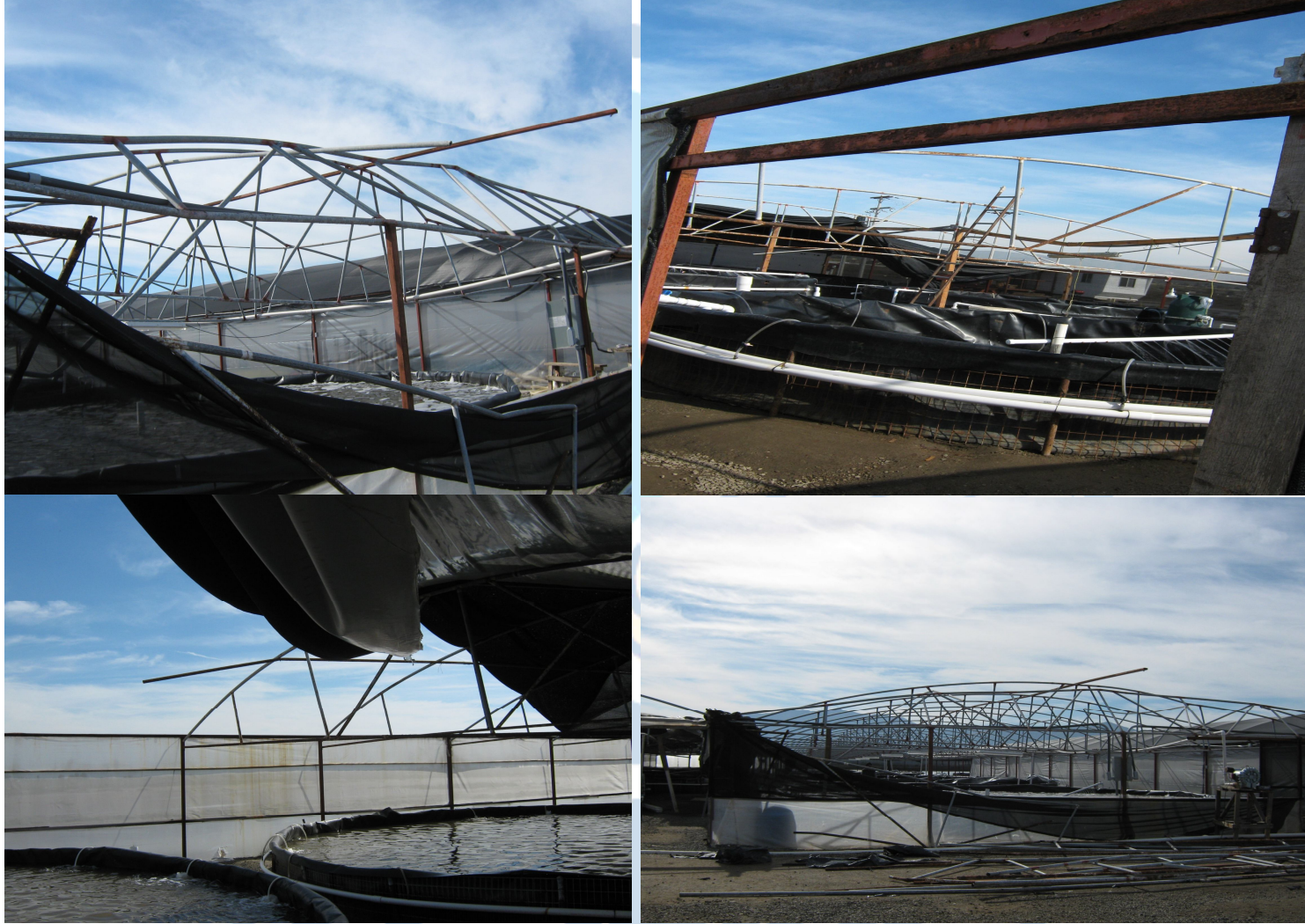
Figura 1.- Instalaciones de la unidad de producción PEZCO donde son evidentes los daños en la infraestructura de la misma, sin embargo reportaron no haber sufrido de problemas sanitarios.
